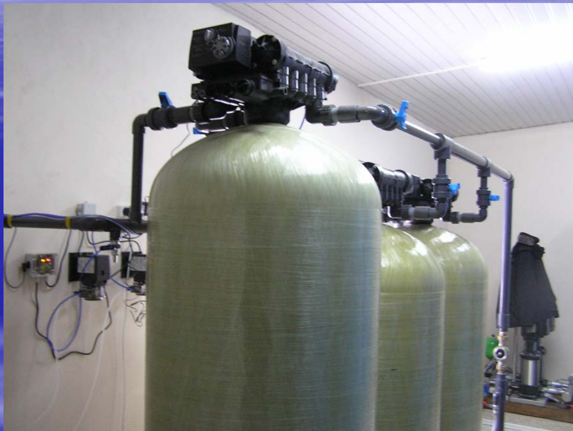
Поселковая станция обезжелезивания.
