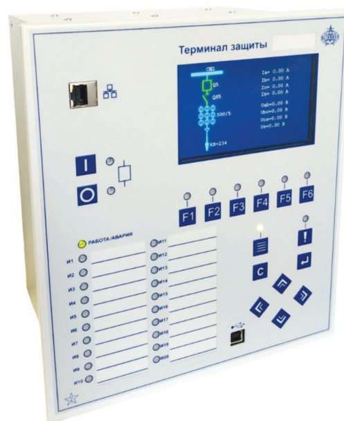
Устройство основной защиты автотрансформатора 330 кВ
